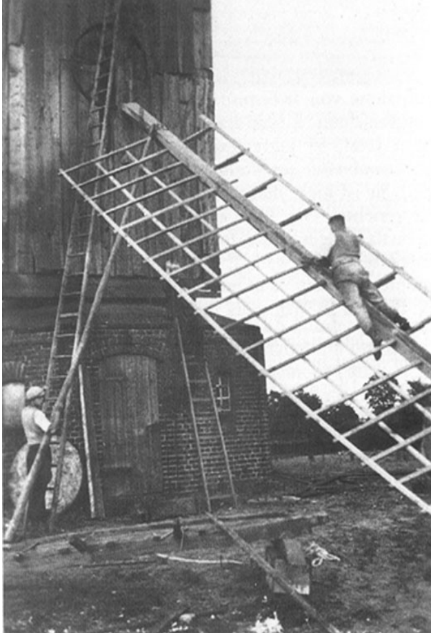
Gerhard Rabe (links) erneuert mit einem Mitarbeiter die Flügel der Schulenburger Mühle Aufnahme von 1935 20
